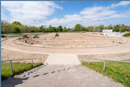
RISA-Sportplatz Hein-Klink-Stadion: Versickerungsanlage mit Rigolen
